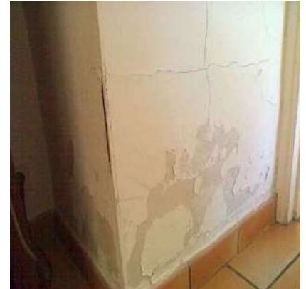
Dégâts sur les crépis
