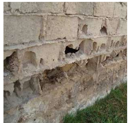
Dégâts sur la maçonnerie
