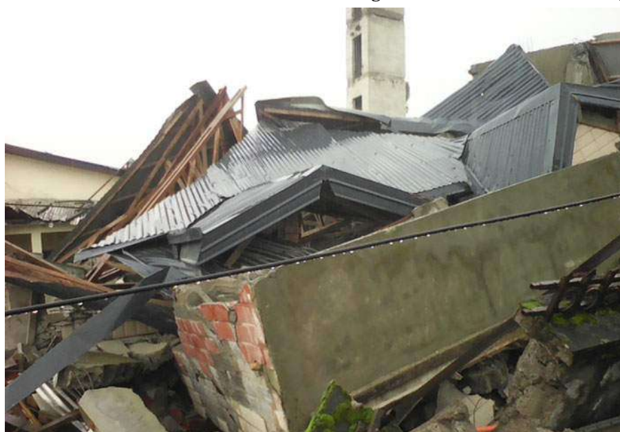
Un immeuble effondré, quelles sont les responsabilités?
