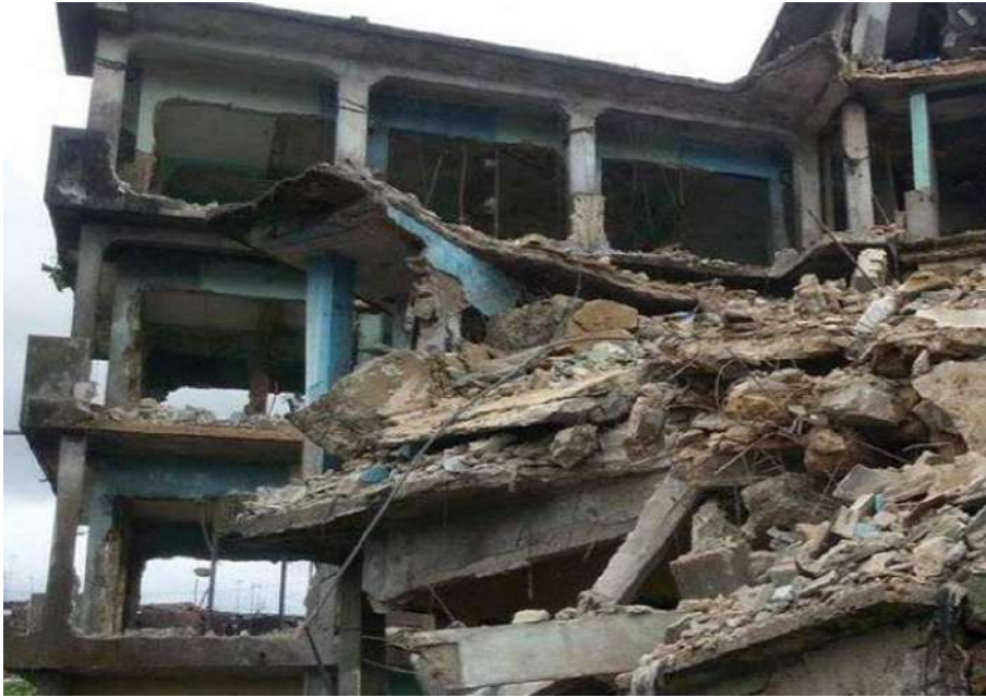
Un immeuble effondré
