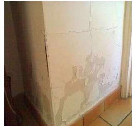
Dégâts sur les crépis
