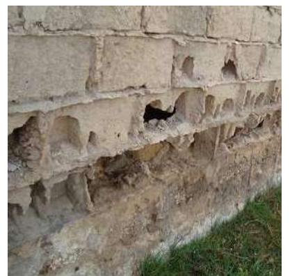
Dégâts sur la maçonnerie
